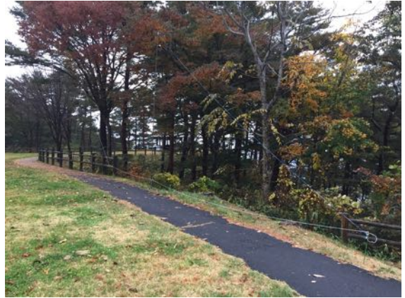
遊歩道の柵沿いに TDDF (Twsited Double Delta Flag) アンテナを設置。写真の左奥が東（海側）。
